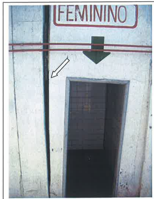
FOTOS 48 / 49: TRINCA NO PISO E PAREDE SOLTA
