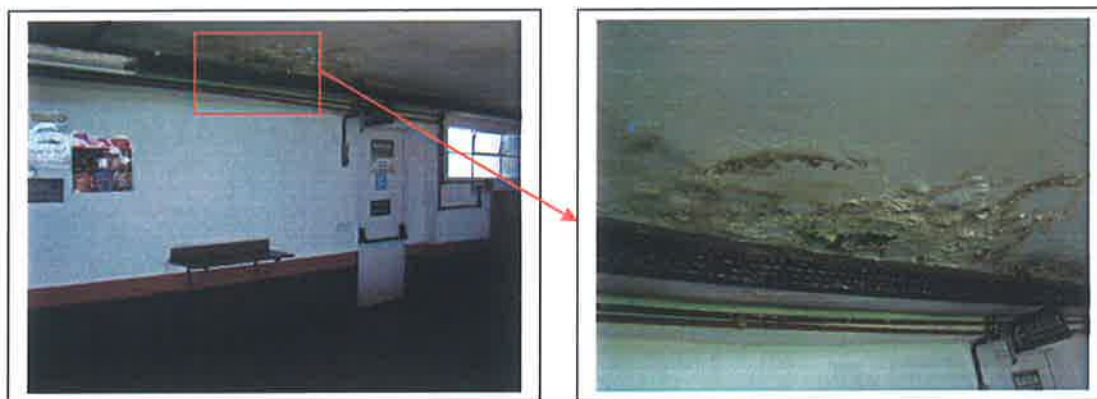
FOTOS 60 / 61: INFILTRAÇÕES NA MARQUISE
