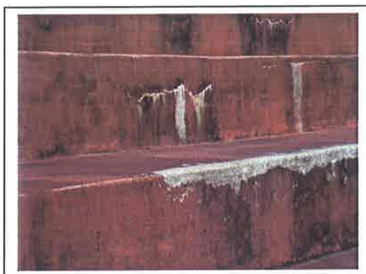
FOTO 23: REPARO FEITO E EFLORESCÊNCIA
