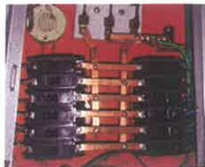
Foto 47: Quadro sujo necessitando de revisão elétrica.
