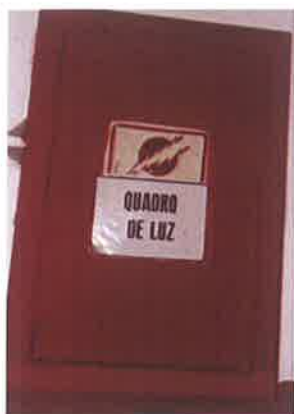
Foto 59: Apresentando quadro identificado com placa de equipamento energizado, o quadro apresenta ainda derivação externa necessitando de melhorias, Vestiário dos Visitantes
