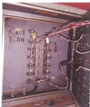
Foto 56: Apresenta conexão dos blocos terminais em boas condições DG Telefonia - Tribuna
