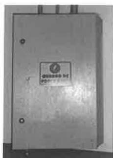
Foto 74: Quadro novo com placa de aviso de equipamento energizado.
