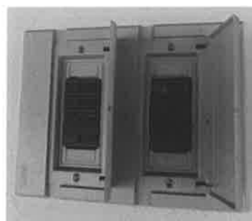
Foto 30: Falta identificação dos componentes. Tribuna de hora – Arquibancada Coberta
