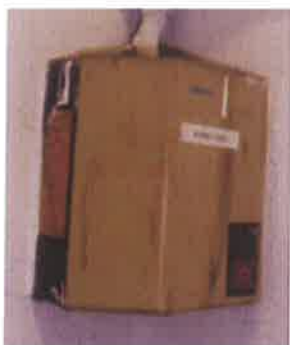
Foto 64: Apresenta quadro de Comando de Bamba em boas condições de conservação, e foi realizado identificação do componente. Vestibulo dos Visitantes.
