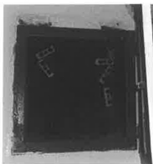
Foto 31: Apresenta quadro de conexão e Telefonia desativado, devendo ser tampado ou retirado do local. Tribuna de hora - Arquibancada Coberta
