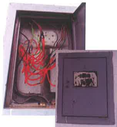
Fotos 36 e 37: O quadro antigo deverá ser lacrado e identificado como caixa de passagem. Quadro de força - Iluminação Externa/Quadras
