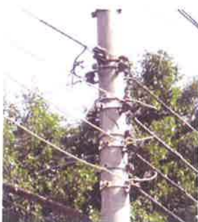
Foto 10: Entrada derivação poste concessionária Em boas condições de conservação Entrada Secundária
