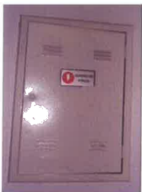
Foto 23: Quadro apresenta placa de aviso de equipamento energizado sua estrutura foi pintura. Alojamento 1e2 / 3e4
