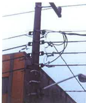
Foto 01: Entrada derivação poste da Concessionária de energia em boas condições de instalação Entrada de Energia Principal
