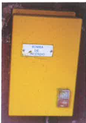
Foto 20: Quadro devidamente identificado, o local não apresenta placa de aviso de equipamento energizado junto à porta do cubículo.
