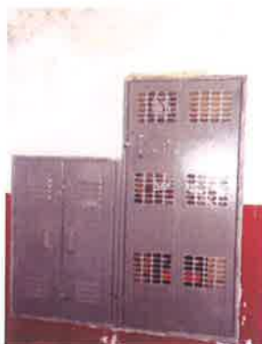
Foto 03: Estrutura reformada com instalação de novos quadros e instalação de porta de forma a restringir o acesso ao cubículo de medição/proteção. Quadro de Medição Principal
