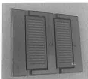
Foto 29: O Quadro novo, falta instalação de placa de equipamento energizado.
