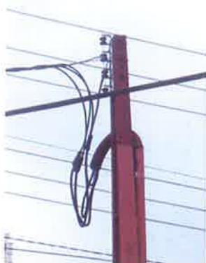
Foto 02: A Entrada de Energia Novo ramal aéreo do Estádio em boas condições, de operação. Entrada de Energia Principal
