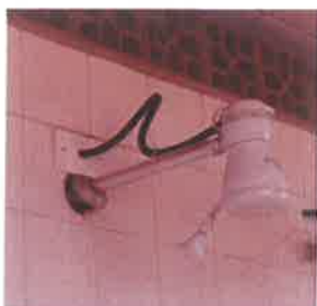
Foto 71: Apresenta ligações de alimentação com instalação de cabos protegidos e com conector de forma a garantir segurança aos usuários. Vestiário Principal
