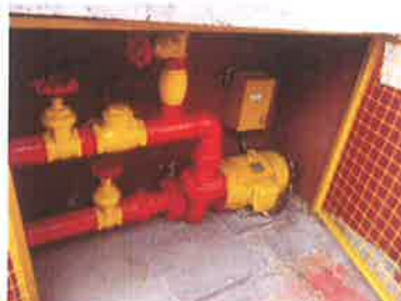
Foto 21: Bomba de incêndio com casa de máquinas em boas condições. Casa de Máquinas – Bomba de Incêndio
