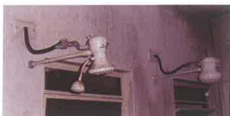
Foto 25: Chuveiros em boas adequações elétricas Alojamento 1e2 / 3e4
