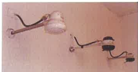
Foto 49: Chuveiros em boas condições de instalação.
