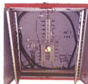
Foto 33: Quadro apresenta necessidade de revisão nas ligações. Quadro de conexão e Telefonia Cabine de Imprensa - Arquibancada Coberta
