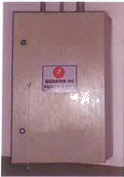
Foto 79: Quadro foi removido sendo instalado um novo quadro que atende as normas vigentes. Quadro de força - Iluminação da Quadra
