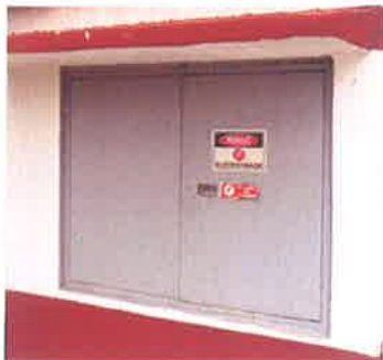
Foto 12: Quadro em local de fácil acesso e protegido contra Intempéries por estrutura de alvenaria.
