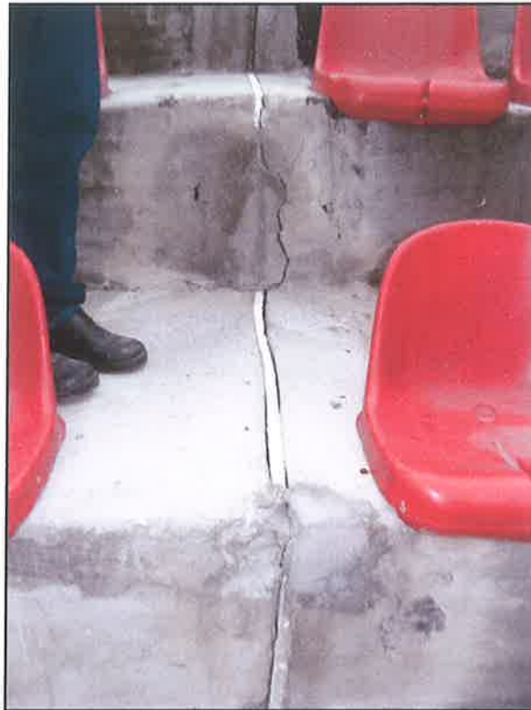
Foto 05 – Falha na junta de dilatação- setor 11.
