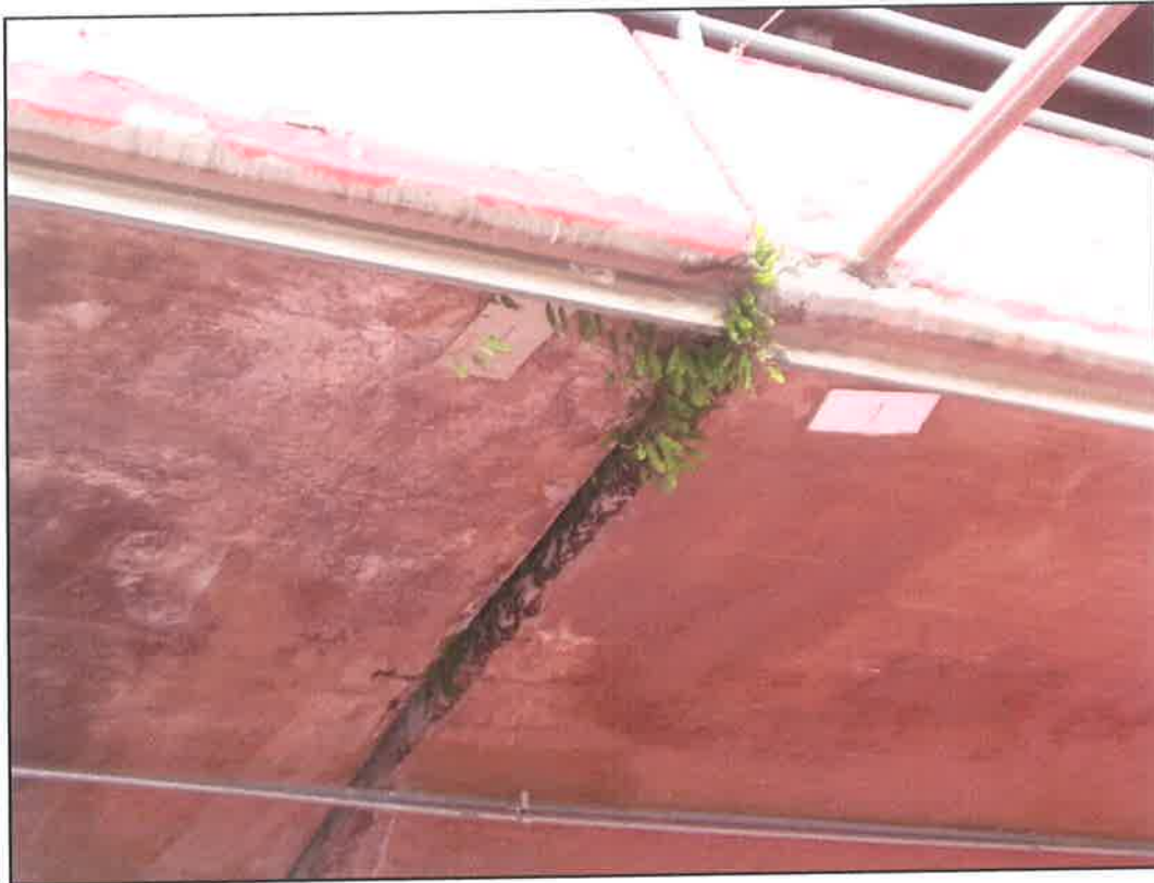
Foto 04- Infiltração da estrutura do anel inferior em frente ao camarote Volks.
