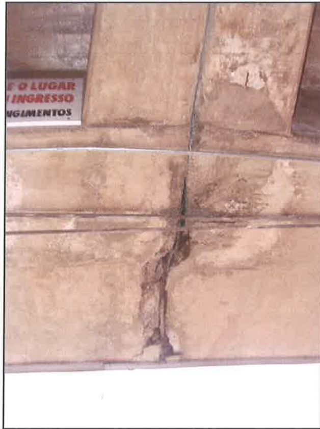
Foto 07 – Estrutura danificada no setor do gigante 39.
