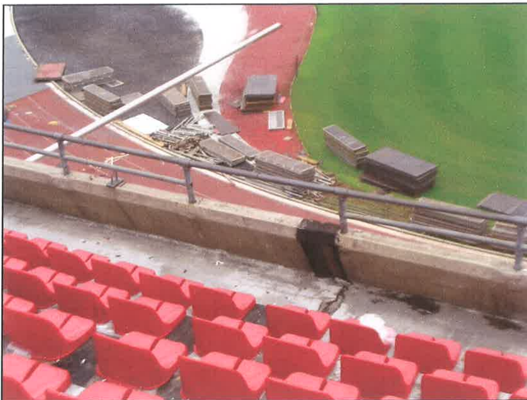
Foto 06 – Falta travessa do guarda corpo do setor 6.
