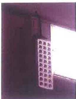
Foto 45: Apresenta Luminária de emergência em conformidade com a norma NBR10989. Vestiário Local
