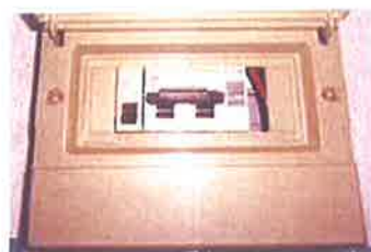
Foto 41: Circuitos não identificados. QFL03 – Vestiário Local
