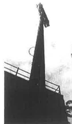
Foto 94: Acesso realizado por escada de marinheiro sem patamar de descanso Torre de Iluminação 3.
