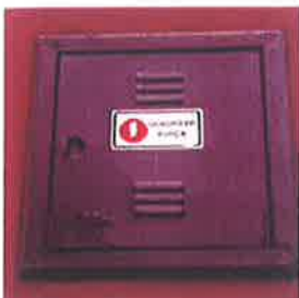
Foto 68: Quadro com placa de equipamento energizado e sem identificação funcional.
