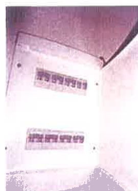
Foto 30: Circuitos não identificados e sem presença de DPR. Vestiário dos Árbitros
