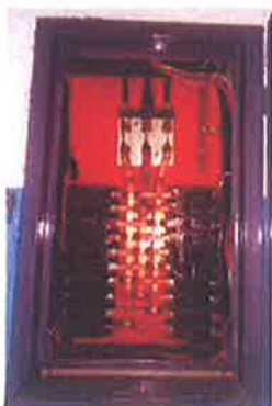
Foto 49: Vista interna do quadro com estrutura em boas condições de instalação. Vestiário dos Visitantes
