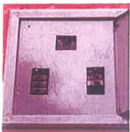
Foto 69: Quadro sem identificação dos componentes. QDL – Cabines
