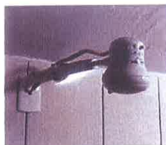
Foto 32: Chuveiros em boas condições de instalação. Vestiário dos Árbitros
