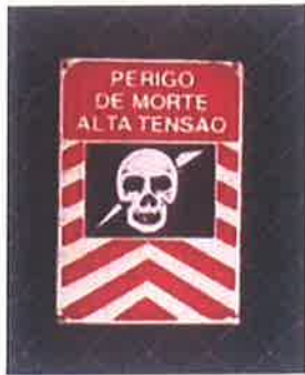
Foto 04: Apresenta de Alta Tensão ou Equipamento Energizado Entrada da Cabine Primária
