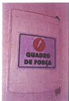
Foto 29: Quadro com placa de aviso de equipamento energizado e sem identificação funcional. precária, deve atender a norma NR10. Vestiário dos Árbitros
