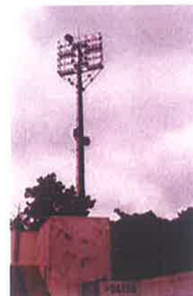
Foto 97: Acesso realizado por escada de marinheiro sem patamar de descanso e com guarda corpo Torre de Iluminação 4
