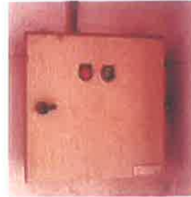
Foto 83: Quadro de Combate a Incêndio Em boas condições de operação. QC - Combate a Incêndio.
