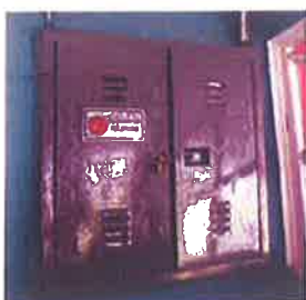
Foto 70: Quadro de conexão e Telefonia com identificação Cabines de Imprensa
