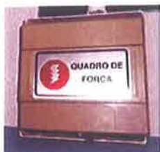
Foto 40: Quadro com placa de aviso de equipamento energizado e sem identificação funcional. precária, deve atender a norma NR10. QFL03 – Vestiário Local
