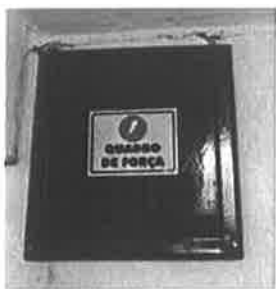
Foto 64: Quadro de força com placa de aviso de equipamento energizado e sem identificação funcional. QFL = Vestiário do Juvenil
