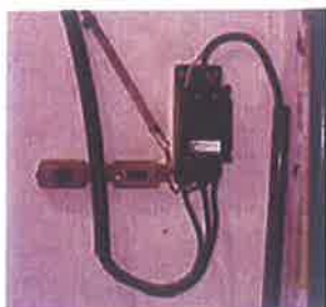
Foto 10: Disjuntor trifásico instalado junto a parede de forma irregular. Cabine Secundária
