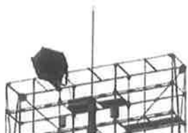
Foto 98: Captor Tipo Franklin Torre de Iluminação 4.
