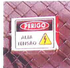
Foto 05: Apresenta aviso contra choques junto as grade dos cubículos. Cabine de Transformação
