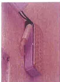
Foto 33: Apresenta Luminária de emergência em conformidade com a norma NBR10989. Vestiário dos Árbitros
