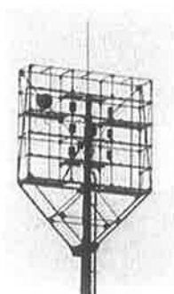
Foto 86: Estrutura suporte de Iluminação não apresenta Luminárias Torre de Iluminação 1.
