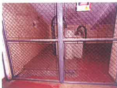
Foto 03: Grade de Proteção contra Choques Junto ao transformador trifásico em boas condições Cabine Secundária
