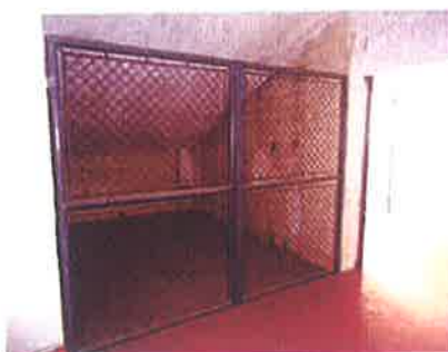
Foto 04:- Apresenta grade bem fechada delimitado a área de alta tensão. Cabine Secundária
