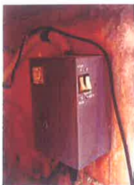
Foto 34: Quadro de comando em boas condições de conservação.
