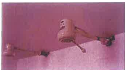
Foto 55: Instalação bem disposta. Vestiário dos Visitantes
