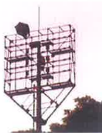
Foto 96: Estrutura suporte de iluminação não apresenta Luminárias Torre de Iluminação 4.
