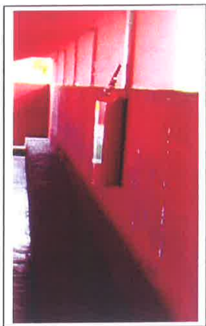
FOTO 41: EXTINTOR DE INCÊNDIO
