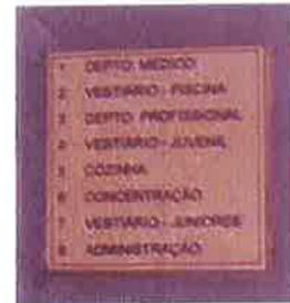
Foto 26: Descritivo os circuitos atendidos junto a tampa do painel. Sala de Fisioterapia
