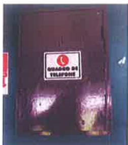
Foto 73: Quadro com indetificação funcional. DG Telefonia - Cabine de Imprensa
