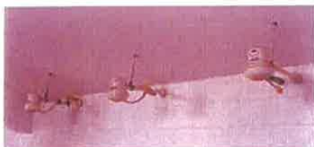
Foto 59: Chuveiros em boas condições de instalação. Vestiário dos Juniores (2)
