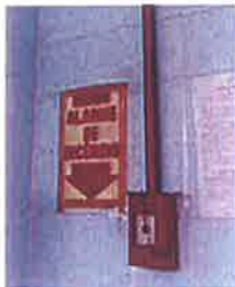
Foto 27: Acionador manual bem sinalizado em local de fácil acesso. Sala de Fisioterapia
