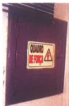
Foto 80: Quadro de força com placa de aviso de equipamento energizado e sem identificação funcional. QFL – Administração
