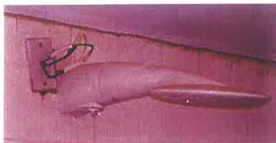
Foto 51: Chuveiros em boas condições de instalação. Vestiário dos Visitantes
