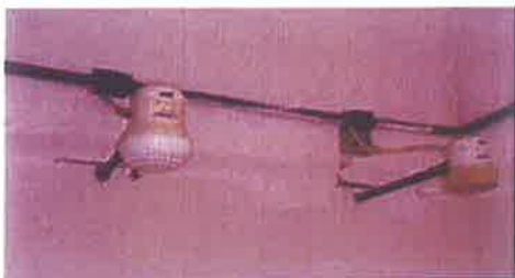
Foto 63: Instalação de chuveiros em boas condições. Posto Policial
