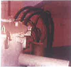
Foto 06: Apresenta instalação de terminal de Conexões de Terra-Neutro em alguns equipamentos da Cabine Secundária
