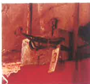
Foto 77: Apresenta pontos de conexão sem intraestrutura em quadro para interligação de telefonia Telefonia - Cabine de Imprensa
