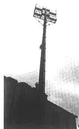
Foto 92: Isolador de afastamento sem cordoalha Torre de Iluminação 2.
