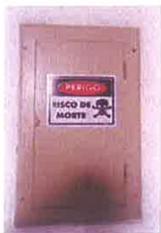
Foto 57: Apresenta placa de aviso de equipamento energizado e sem identificação funcional. Vestiário dos Juniores (2)
