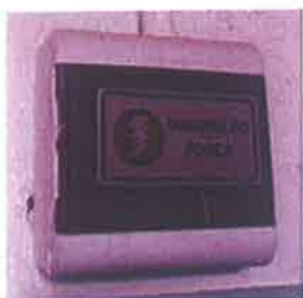
Foto 38: Quadro com placa de aviso de equipamento energizado e sem identificação funcional. precária, deve atender a norma NR10. QFL02 – Vestiário Local
