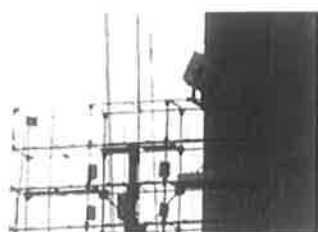
Foto 95: Captor Tipo Franklin Torre de Iluminação 3.
