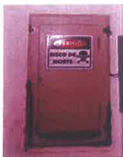
Foto 53: Quadro com placa de equipamento energizado e sem identificação funcional. Vestiário dos Visitantes (3)
