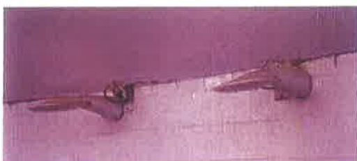
Foto 50: Instalação bem disposta. Vestiário dos Visitantes
