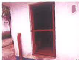
Foto 82: Cabine delimitada em boas condições de conservação. Combate a incêndio.
