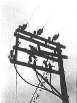
Foto 01: Entrada Principal junto concessionária em bom estado Entrada de Energia
