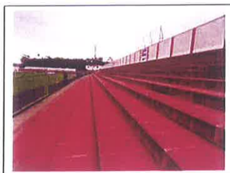
FOTO 15: VISÃO GERAL E NUMERAÇÃO APAGADA SETOR 3
