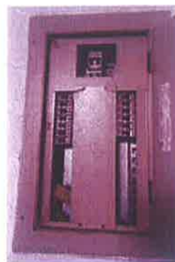
Foto 58: Quadro sem identificação dos componentes e com área abertas junto ao painel frontal. Vestiário dos Juniores (2)
