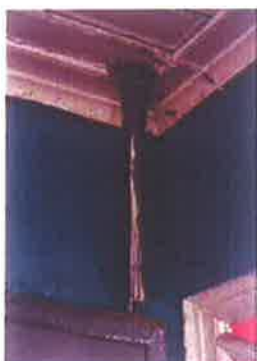
Foto 72: Quadro apresenta derivações externas junto à porta do painel necessitando de manutenção Cabines de Imprensa
