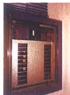
Foto 81: Sem identificação dos componentes junto a placa de proteção. QFL – Administração
