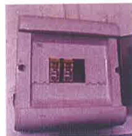
Foto 39: Circuitos não identificados e sem presença de DPR. QFL02 – Vestiário Local
