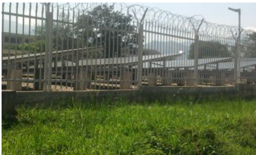
Fig. 4: Cellules photovoltaïques de l'hôpital Roi Khaled de Bujumbura
