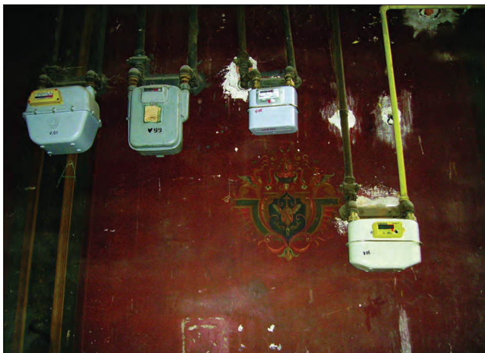
Strada Mureșenilor nr. 3. Contoare montate pe peretele pictat al gangului de intrare în curte
