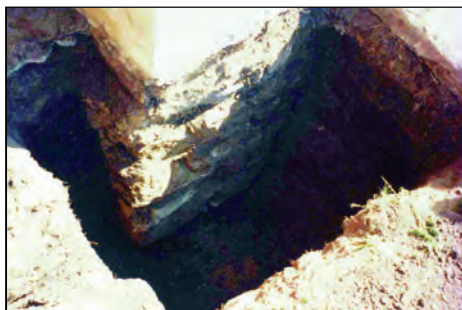
Foto 11. Sondaj realizat la fundația unui stâlp de susținere a porticului. Se observă evazarea blocului față de laturile stâlpului
