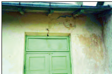
Foto 23. Fisură în dreptul golului ușii de acces la parterul clădirii
