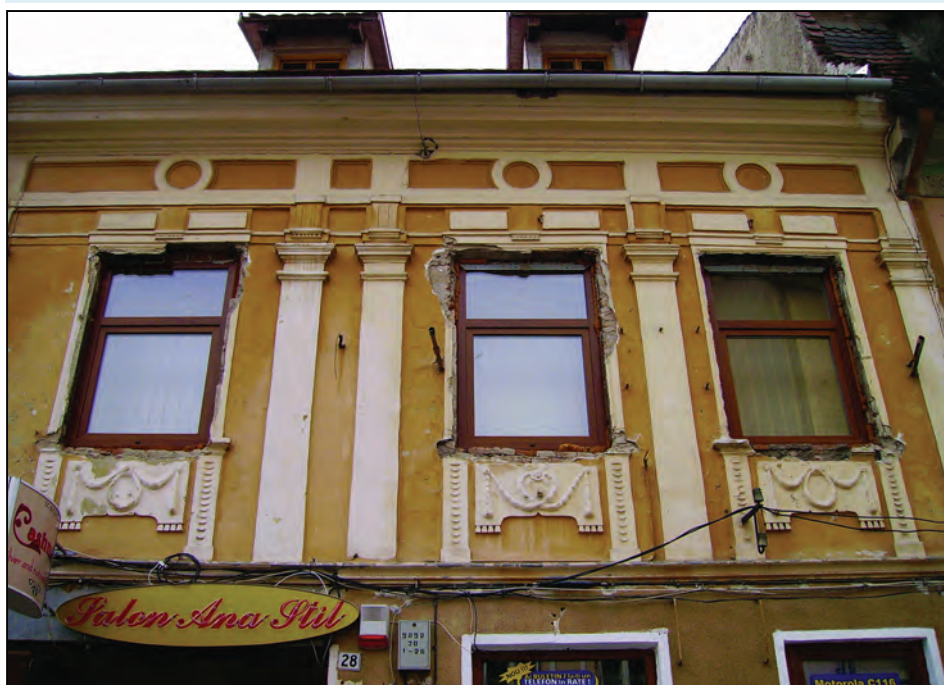
Strada Republicii nr. 28. Ancadramente distruse de montarea geamurilor termopan
