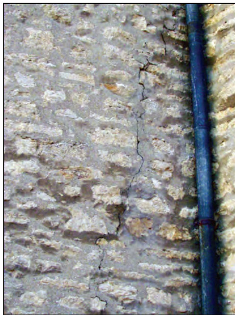
Fig. 16 – Fisură în dreptul pronaosului – fațada nord
