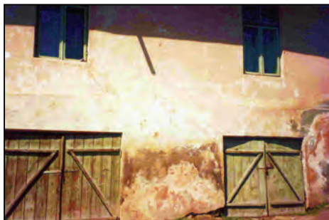
Foto 22. Apariția și dezvoltarea fisurilor în dreptul golurilor, pe fațada laterală dreapta
