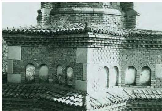
Foto 4 – Degradări din umiditate la ocnițe și fisuri între absidă și altar
