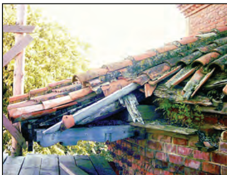
Foto 5 - Alte degradări ale șarpantei
