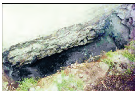
Foto 10. Sondaj realizat la exteriorul clădirii la fundația pereților portanți. Se observă structura fundației alcătuită din piatră.
