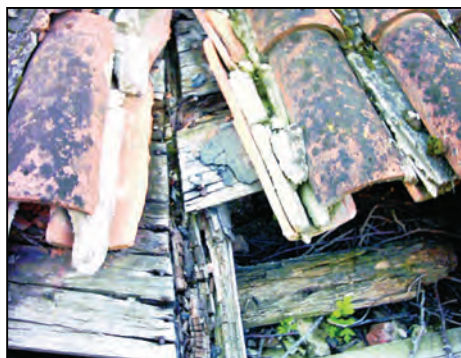
Foto 8 – Degradări accentuate ale șarpantei
