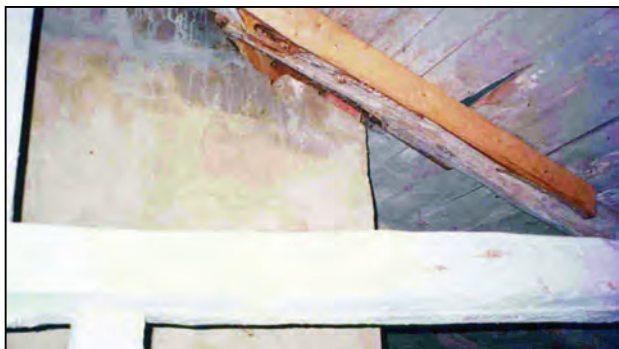
Foto 24. Infiltrații prin acoperiș în zona racordării învelitorii la un coș de fum. Se observă inițierea și dezvoltarea procesului de putrezire a elementelor de lemn ale șarpantei
