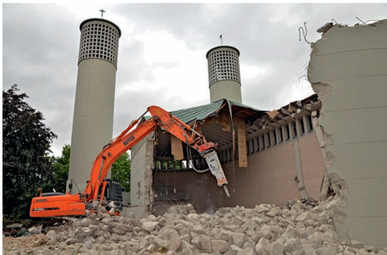
Abb. 24: St. Ludgerus. Abriss der Kirche im Sommer 2013.
