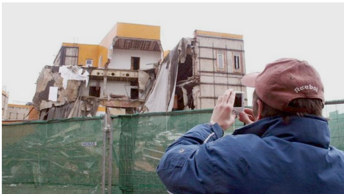
Obr. č. 29: Březen 2009, fotografie z prvního dne březnové destrukce OD Ještěd. Zdroj: Machová, 2009.
