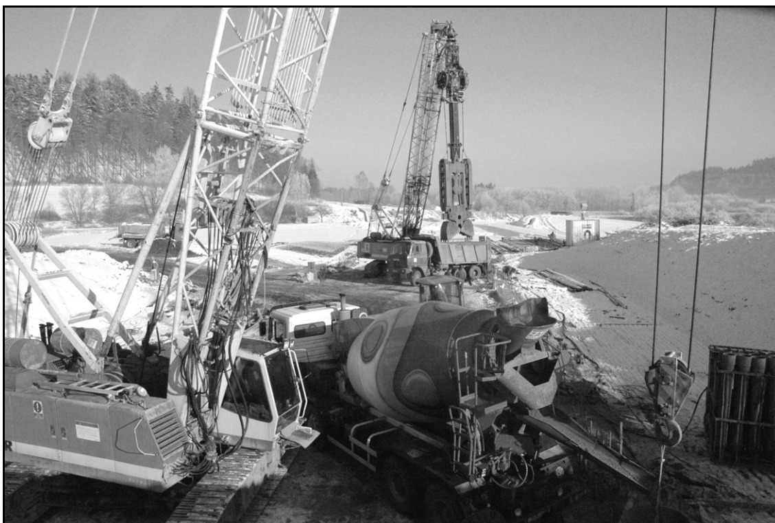
Obr. 1 – Provádění podzemních stěn na objektu zárubních zdí (rudoltická strana), v popředí probíhá betonáž lamely podzemní stěny, v pozadí těžba rýhy.
