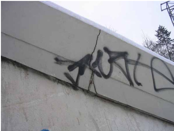
obr.4 trhlina v římse
