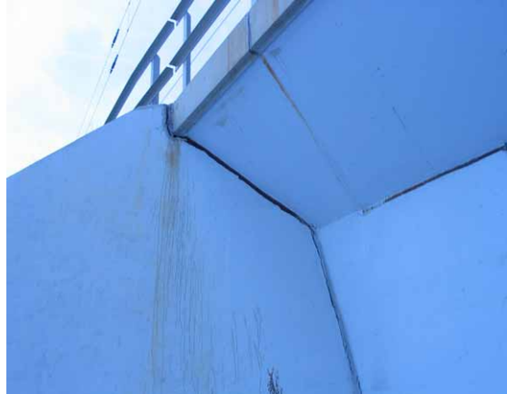
obr.5 trhlina mezi opěrou a spodní stavbou
