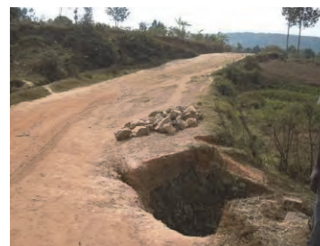
Fissures de la route a cote de la rivière
