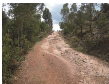
Pente gravement érodée par l'eau à Buraza
