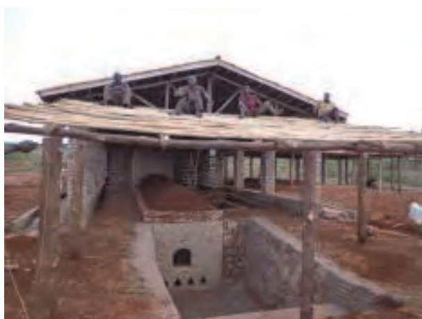
Four tunnel pour la fabrication des tuiles du PP8
