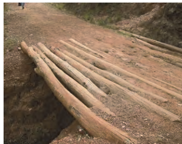
Pont en bois peut être emporté par l'érosion à Buraza
