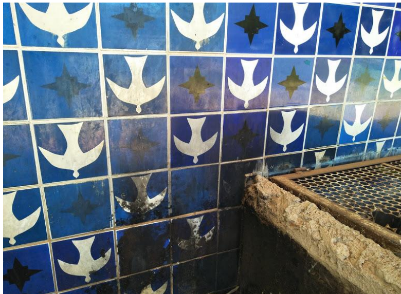
Figura 40 - Azulejos danificados na fachada posterior da Igrejinha, 2018
