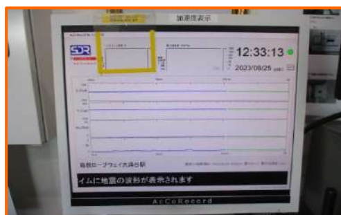
【デジタル地震監視システム】
