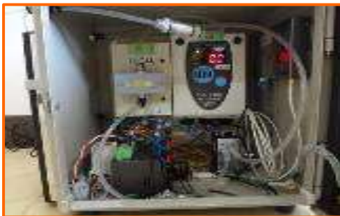
【大涌谷駅舎内火山ガス計測機器】
