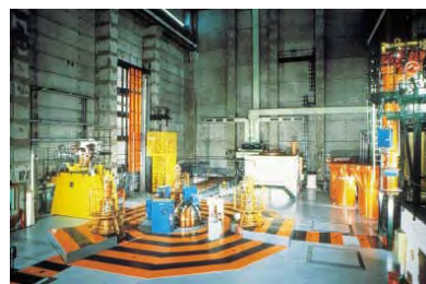
Figure 1 : Le hall du réacteur Phénix, accessible en fonctionnement
