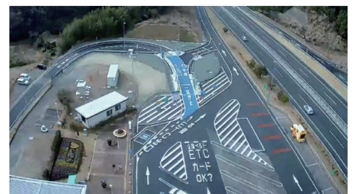
東京湾アクアライン連絡道 東京湾アクアライン管理事務所管内舗装補修工事
