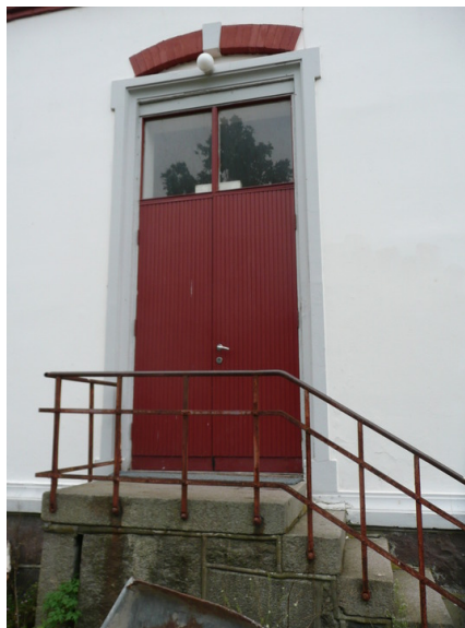
Dagens inngangsdør står ikke i stil med husets arkitektur. Opphavsrett: Statsbygg.
