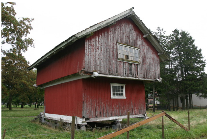
Forfallet er størst på sørveggen. Opphavsrett: Statsbygg.
